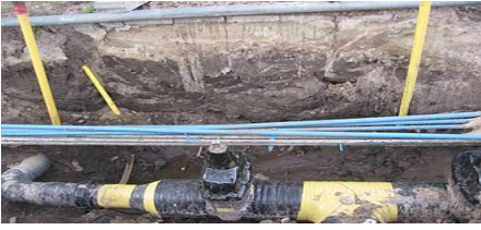
Fig. 40 Ondergrondse leidingen waaronder ook elektriciteitsleidingen.
