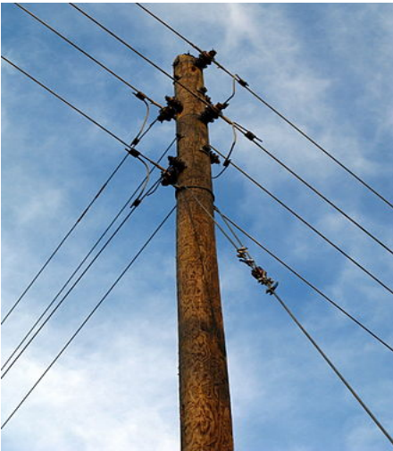
Fig. 41 Luchtlijnen van een lokaal elektriciteitsnet in Oostenrijk.
